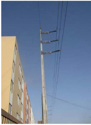
Figura 1. Línea de transmisión trifásica (66 kV, 16 metros de altura) en estudio.
